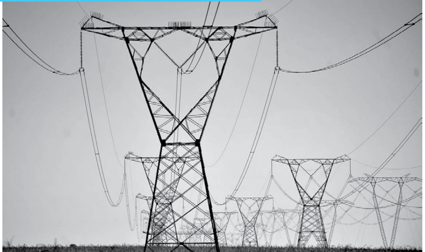
Os projetos contemplam subestações e linhas de transmissão em doze estados do país, que totalizarão uma extensão de 2.470 quilômetros
